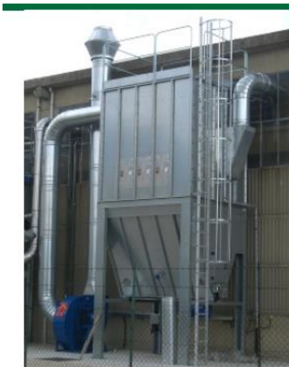
Dispositif de traitement de l'air par filtre à manches et cheminée d'éjection de l'air épuré
